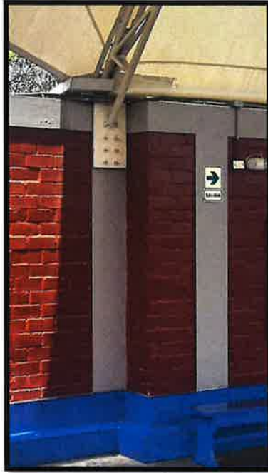
Fig. 02 – Muros presentan grietas (Lugar de anclaje no adecuado)
